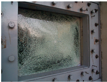
Bild 5: Glasbruch durch Explosionsbelastung
